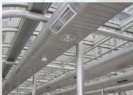
Sistemas de ar condicionado
